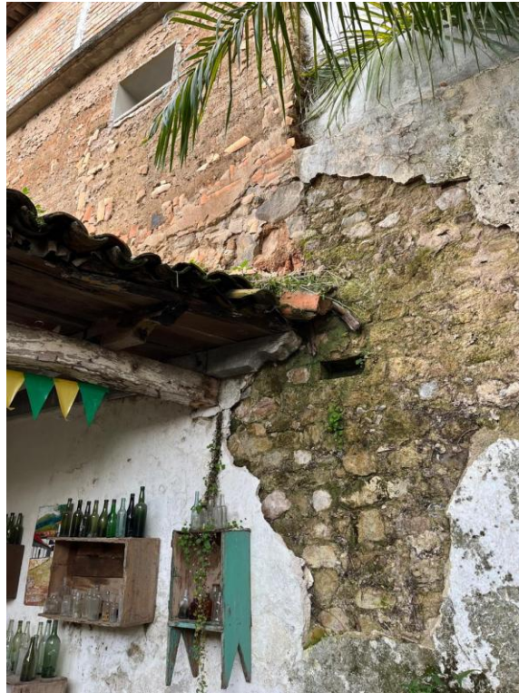
Pared exterior deteriorada y alero de madera teja a punto de ceder.
