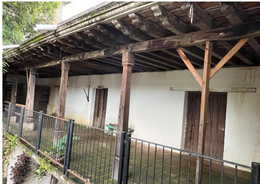
Aleros, pisos travesaños y puertas de corredor totalmente dañados (área fuera de acceso por el grado de peligro al visitante)
