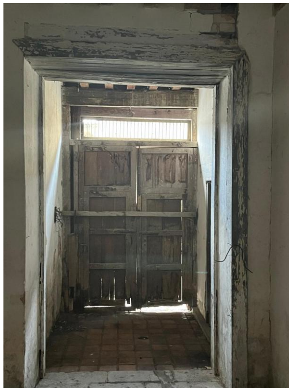
Puerta de acceso exterior a calle principal deteriorada y pared afectada estructuralmente.
