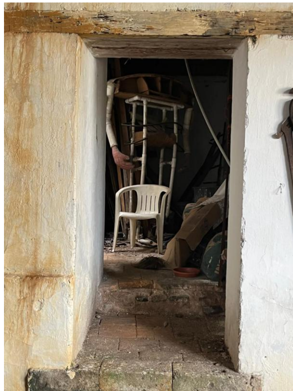
Habitación en segunda planta, donde el techo ya cedió en su totalidad.
