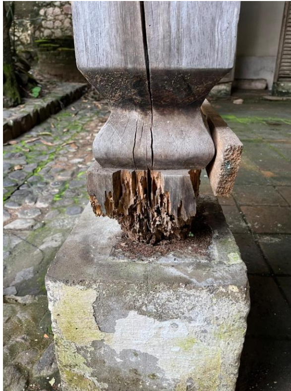
Columna de madera de segunda planta totalmente en su base, dañada por la presencia de humedad y carcoma.
