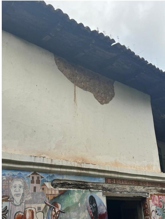
Repello de pared exterior cediendo, techo con presencia de humedad y malas condiciones de travesaño de puerta.
