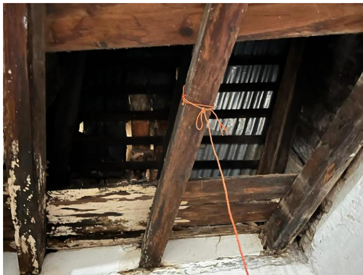
Tabanco de madera sobre la cocina colapsado dejando entrar aguas lluvias sobre estructuras de adobe.
