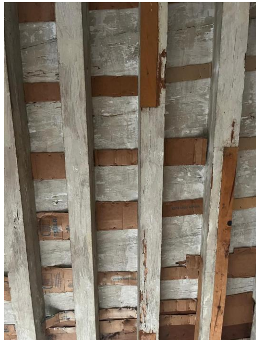
Piso de entresuelos deteriorados, a punto de ceder.
