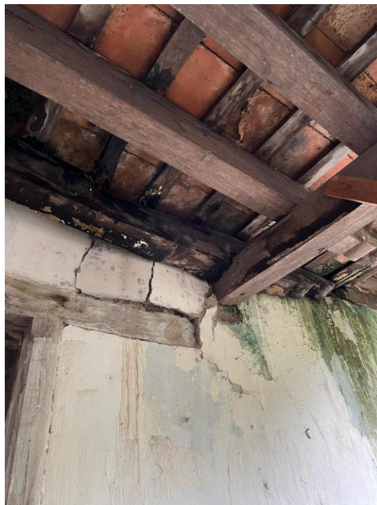
Techo de madera y teja a punto de ceder y pared agrietada
