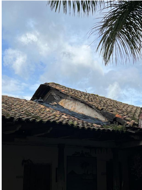
Techo de teja dañados a punto de colapsar.
