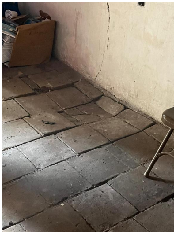
Piso de losetas de barro en segunda planta con humedad y hundimiento.
